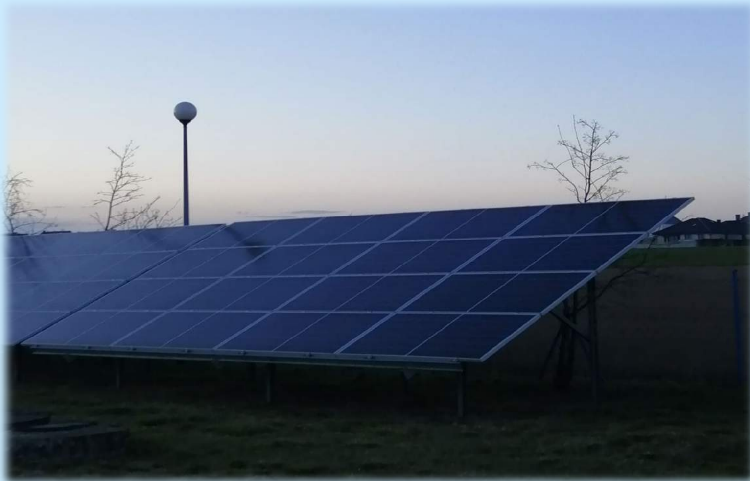
Panele fotowoltaiczne przy Stacji Uzdatniania Wody w Pleszewie
